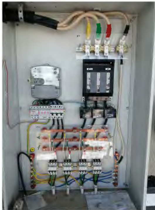
Рисунок 7.1. Загальний вигляд щита збору потужності змінного струму.
