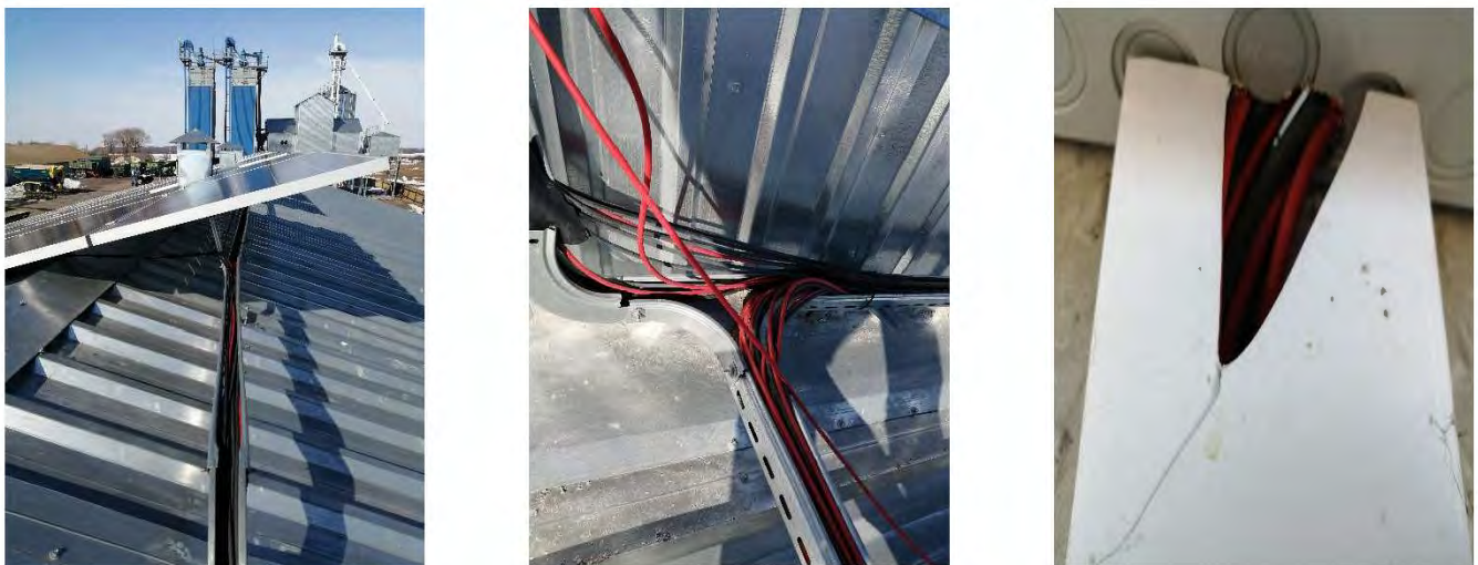
Рис.3.Не належна прокладка кабельних трас постійного струму (додаткові фотографії наведені у додатку 6)
